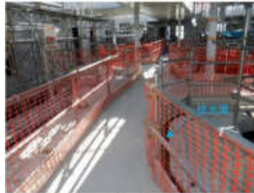
Хагарал руу тасралтгүй усаар хангахын тулд хучилтын хавтангийн дээд хэсэгт ус зайлуулах хоолойд ус хадгалдаг. 2022 оны 6-р сарын 1-нд авсан зураг
